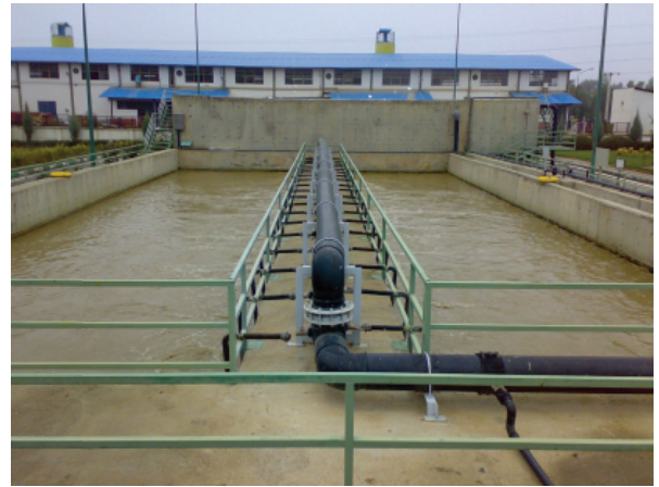
شکل ۱: واحد هوایی عمقی تصفیه خانه آق قلا
